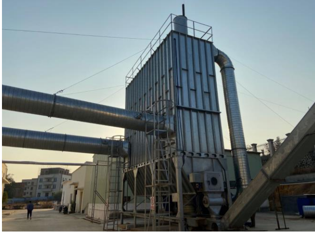
粉尘处理装置
