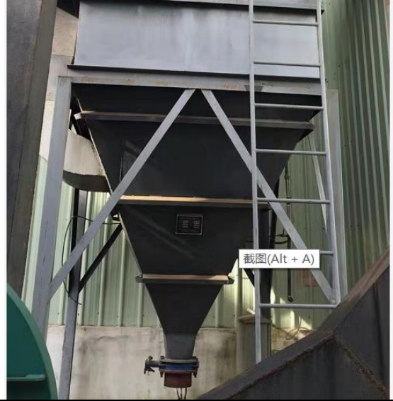
锅炉废气处理装置
